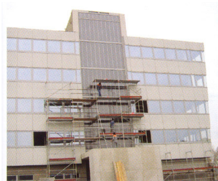
Slika 1: Toplozračni sprejemniki sončne energije na južni fasadi Tehnološkega parka III
